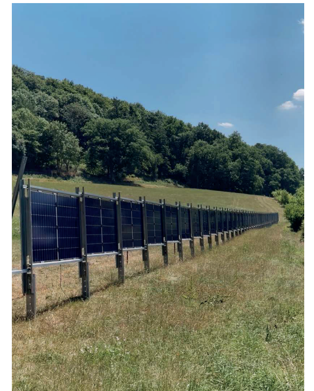
Photovoltaik-Zaun in voller Länge
