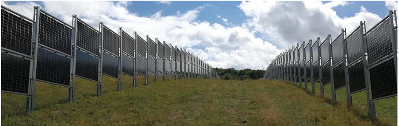
Abbildung 4: Vertikal montierte, bifaziale Module (Quelle: Next2Sun)
