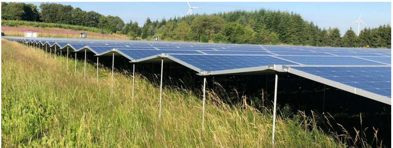
Abbildung 1: Freiflächenphotovoltaikanlage mit Ost-West-Orientierung
