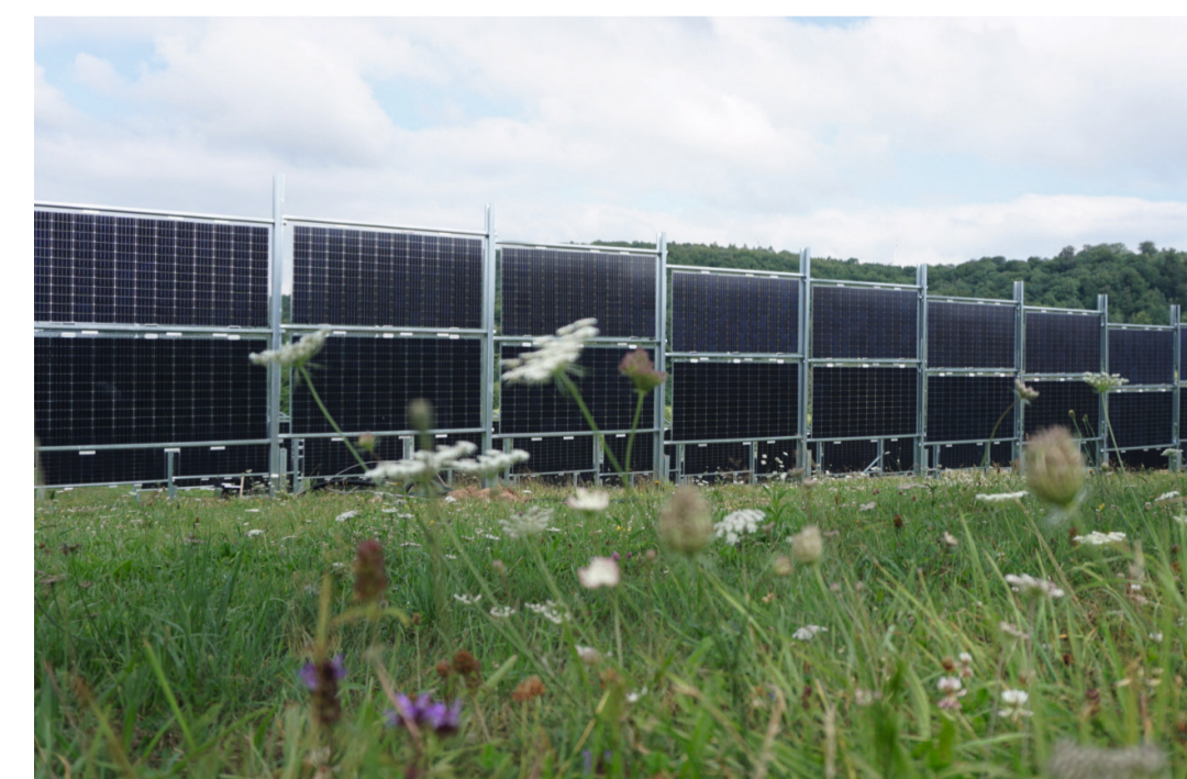
Erste Agrophotovoltaikanlage im Saarland © Next2sun GmbH
