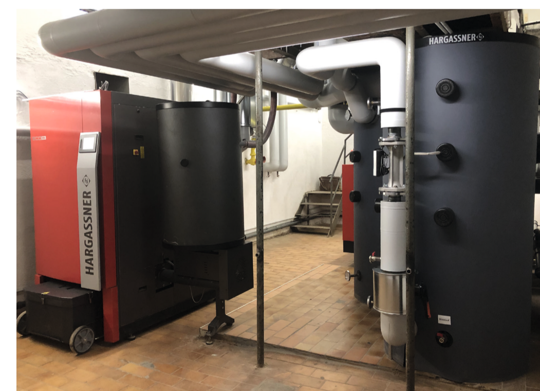
Neue Pelletheizung für das Rathausumfeld in Mandelbachtal © HGE Ingenieur GmbH
